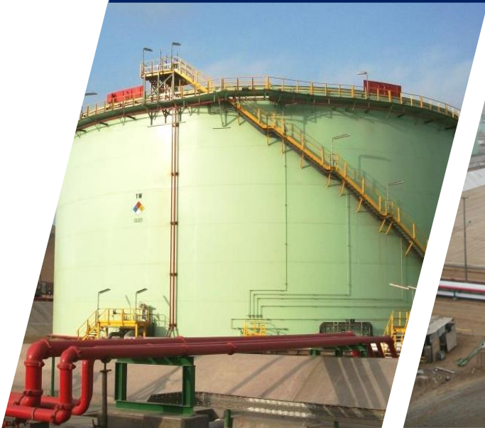
PEM Tanques de crudo
